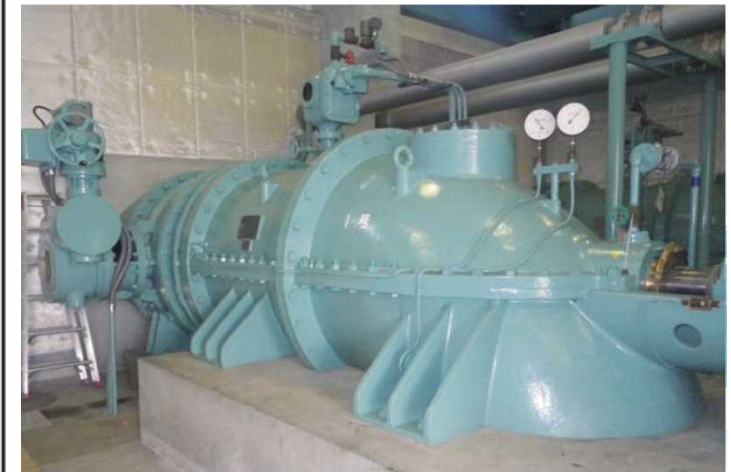
米原排水機場
