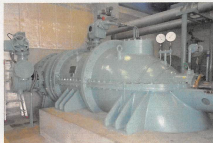
米原排水機場
