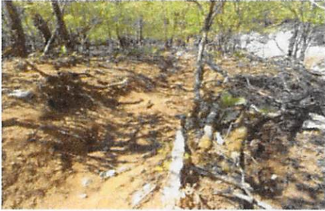
土壌流出の発生状況
