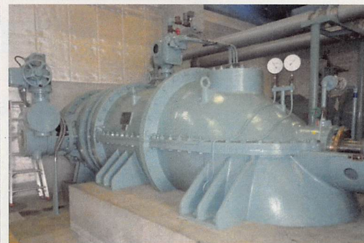
米原排水機場
