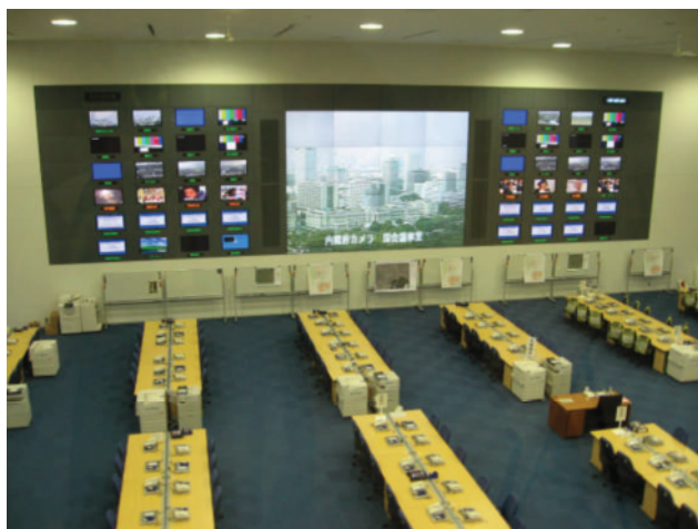
参考) 有明の丘基幹的広域防災拠点施設 オペレーションルーム
