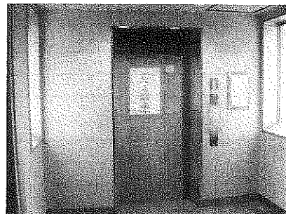
エレベーター
