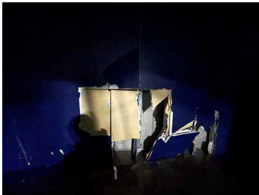
図5 破損した周辺の壁
