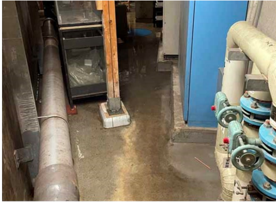
図8 バックヤードの浸水
