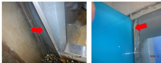
C 内部から見た水槽右側の亀裂(点線枠の部分)
