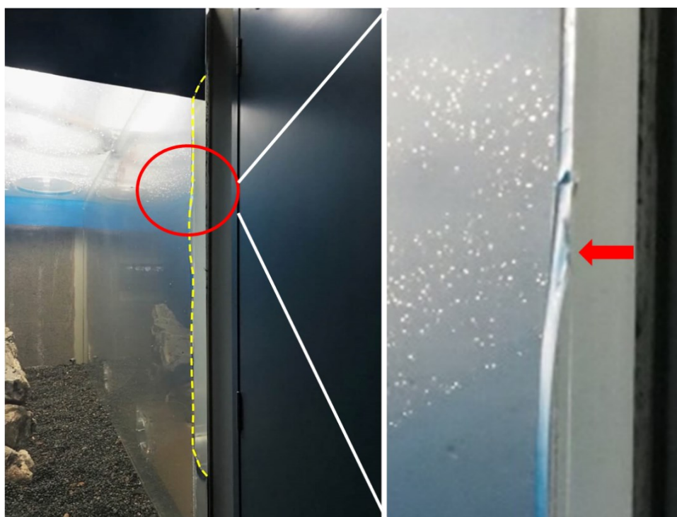
図31 ふれあい水槽の亀裂の位置(左)と破断面の切り替わり(右・矢印部分)
