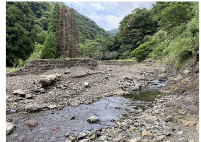
既設砂防堰堤の堆砂状況 (針川)
