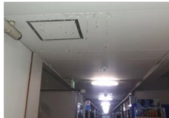
天井からの漏水 (R5)
