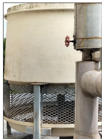
冷房装置故障 (R3)
