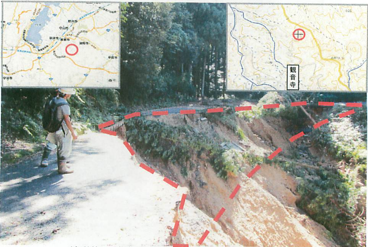
林道施設被害 路肩欠損（栗東市 心行路線）
