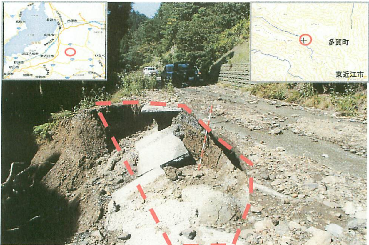
林道施設被害 路肩欠損（多賀町 御池線）
