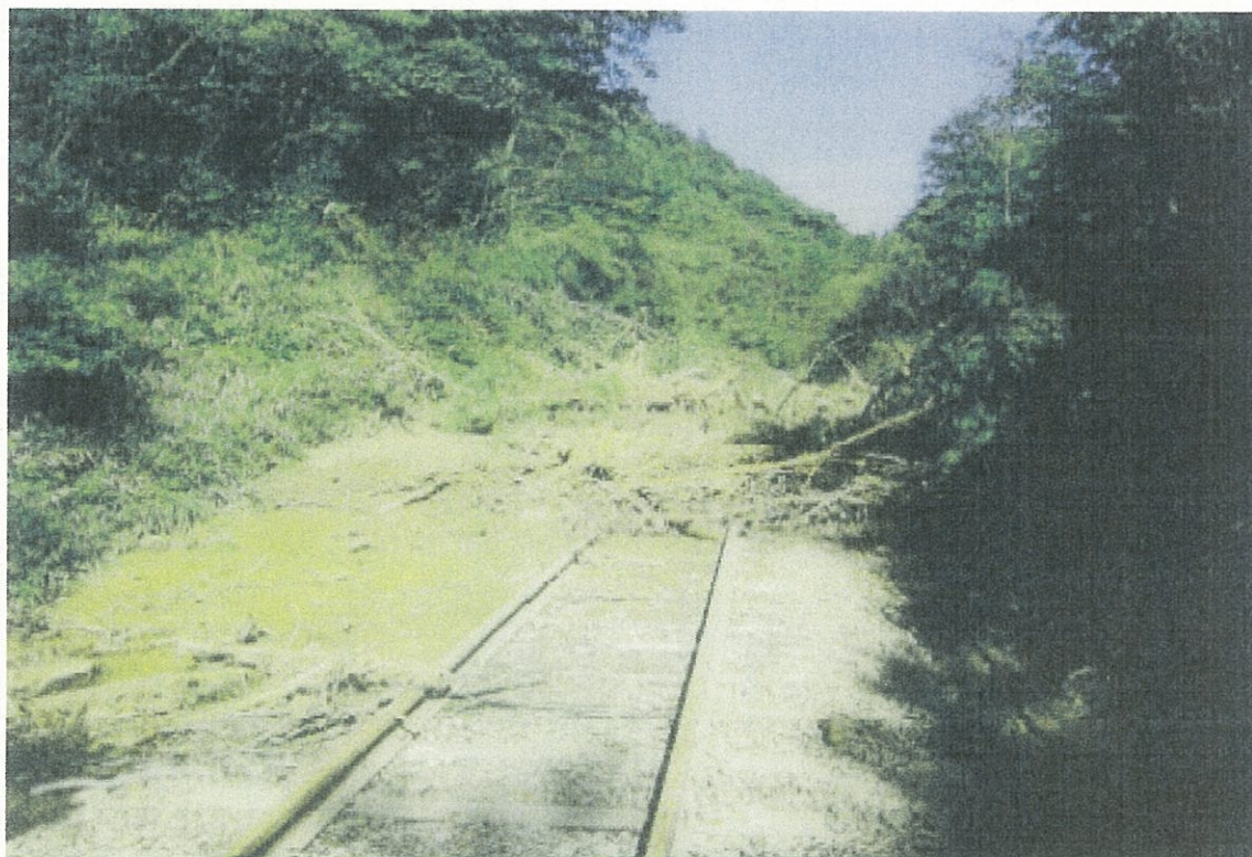
③土砂流入現場（貴生川起点 5.1km 付近）
