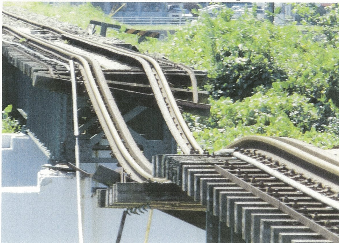
① 杣川橋梁流失現場（貴生川起点 733m）【拡大】
