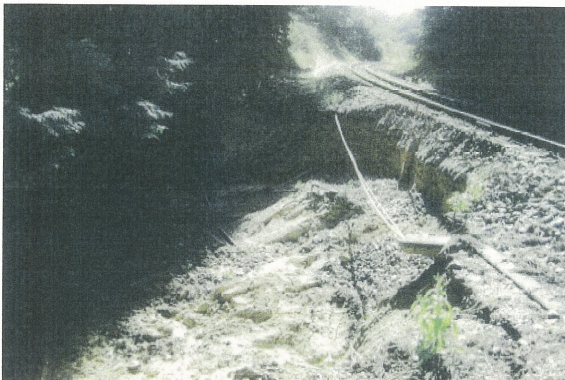
②法面崩壊現場（貴生川起点 2.9km 付近）
