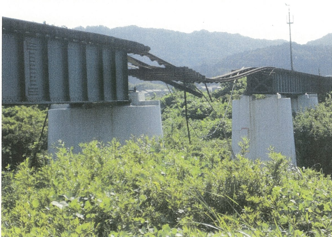
① 杣川橋梁流失現場（貴生川起点 733m）【被災後】
