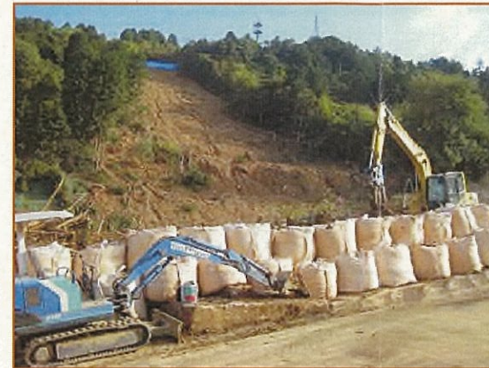
写真：台風 18 号被災地（栗東市がけ崩れ現場）
