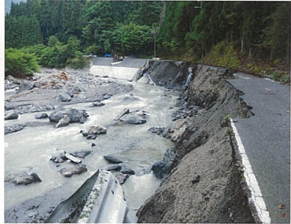
■河5 安曇川(大津市葛川木戸口) 護岸欠損 L=80m
