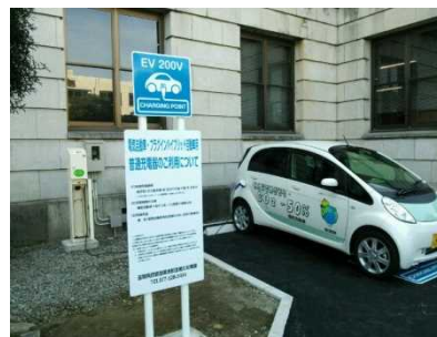
H26.3 県庁設置充電器
