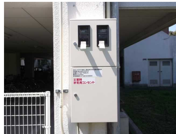
災害時非常用コンセント
