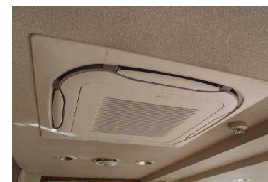
高効率空調設備への更新
