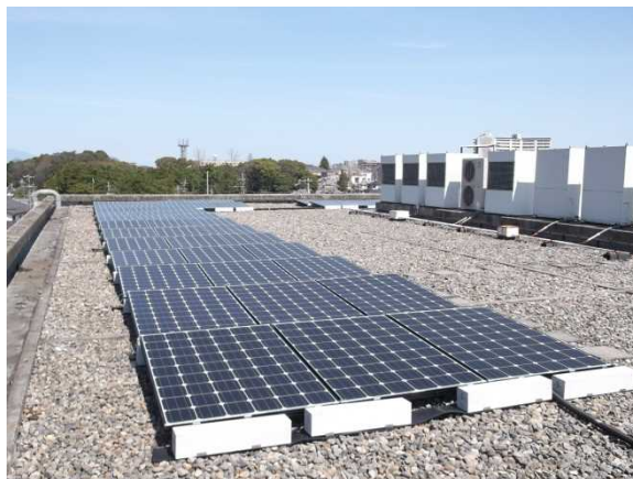
校舎屋上に設置された太陽光パネル
