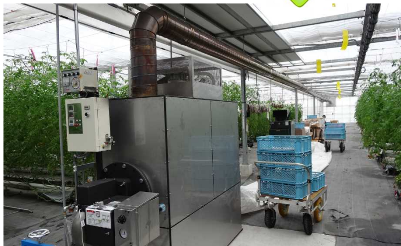
ハウス内に設置された廃食油温風ボイラー
