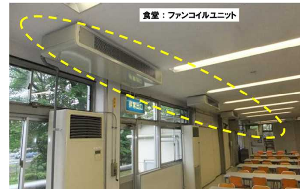
食堂ホールの空調補助として
