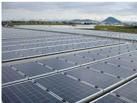
草津センター 118.6kW (草津市上寺町) ※平成25年11月～ 売電開始
