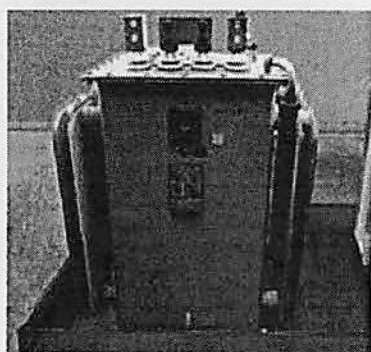
高圧トランス
