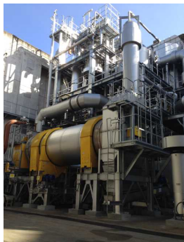
図 3-23 湖西浄化センター汚泥燃料化施設
