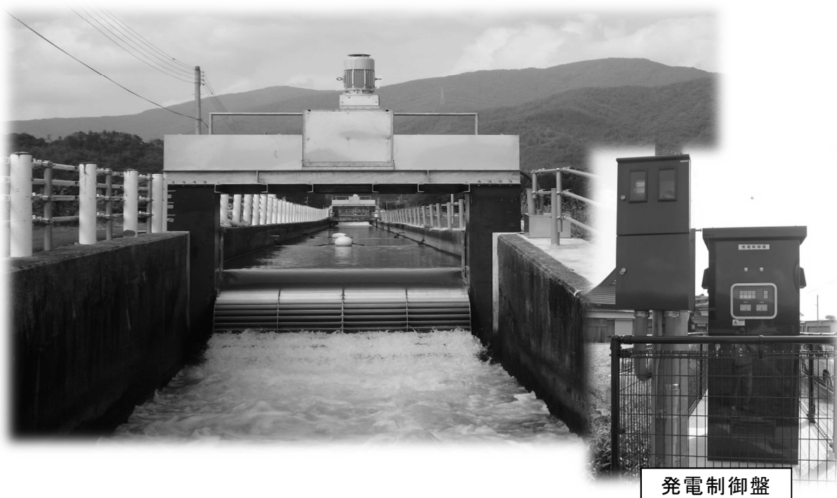
湖北地区 小水力発電施設（4号水車）
