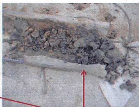
無理な打設により鋼矢板先端部が大きく損傷
