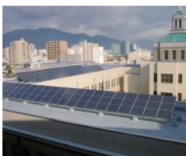
太陽光発電施設(県庁本館)
