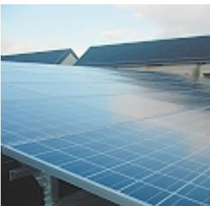
ソーラー発電設備（滋賀県琵琶湖環境科学研究センター）
