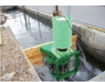
小水力発電施設
