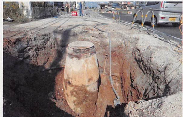
マンホールの損傷状況
