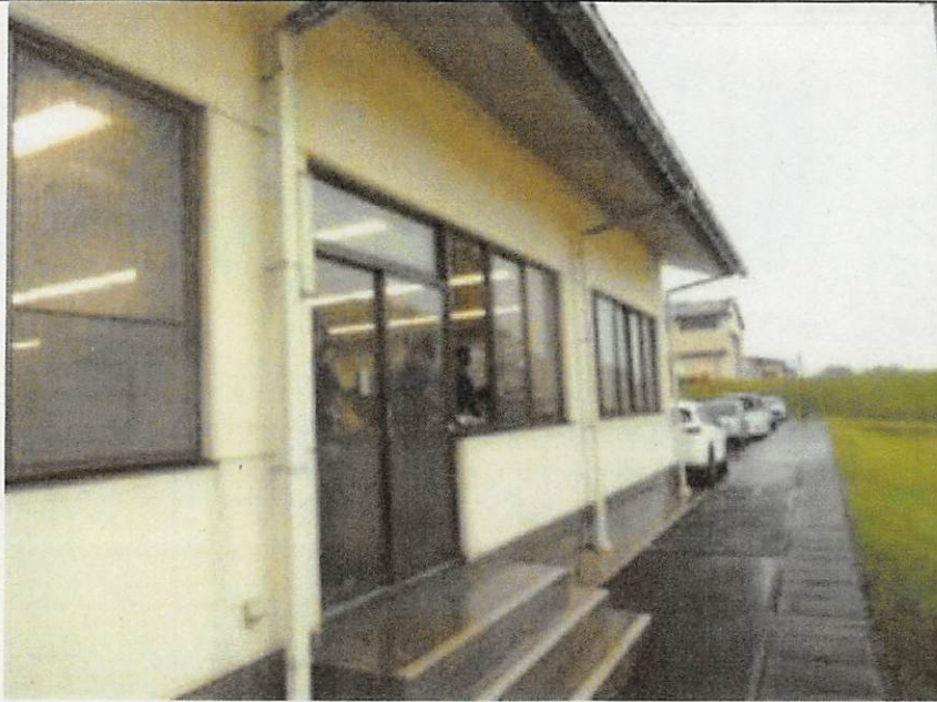
撮影項目 機動警察隊 窓ガラス損壊状況
