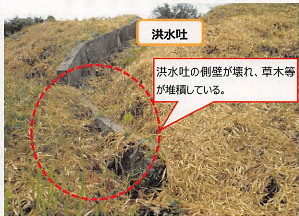
図Ⅲ-2 管理が十分でないため池
