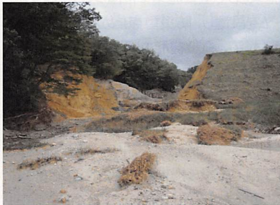
図Ⅲ-7 平成 29 年の台風 21 号によるため池堤体の決壊
