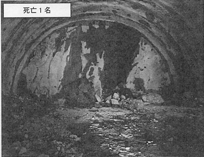
崩落した切羽の様子
