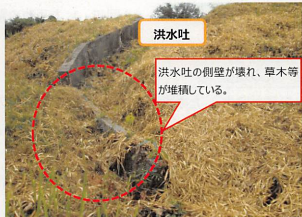
図Ⅲ-2 管理が十分でないため池
