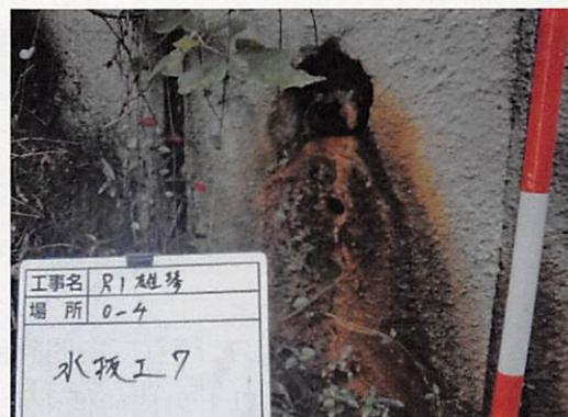
水抜き工の管閉塞（大津市雄琴地区）
