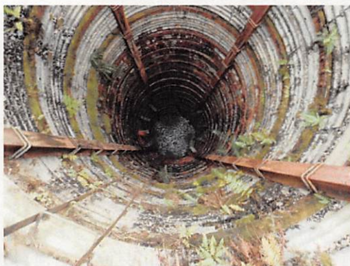
昇降トラップが腐食した集水井（大津市上仰木地区）
