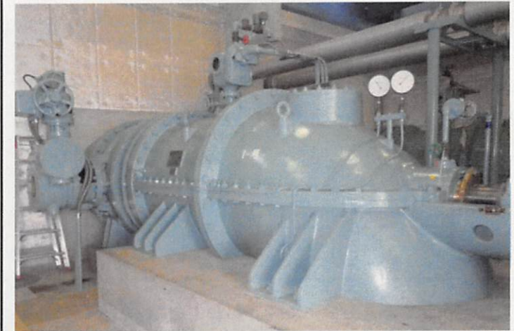
米原排水機場
