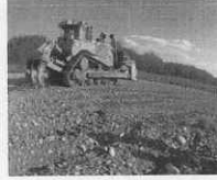
細粒分の流下促進によるアコの産卵環境の改善のための豊知川固定化砂州におけるアーマコート破壊（河床耕転）事業
