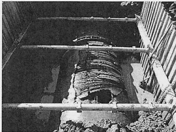
管水路の破損
