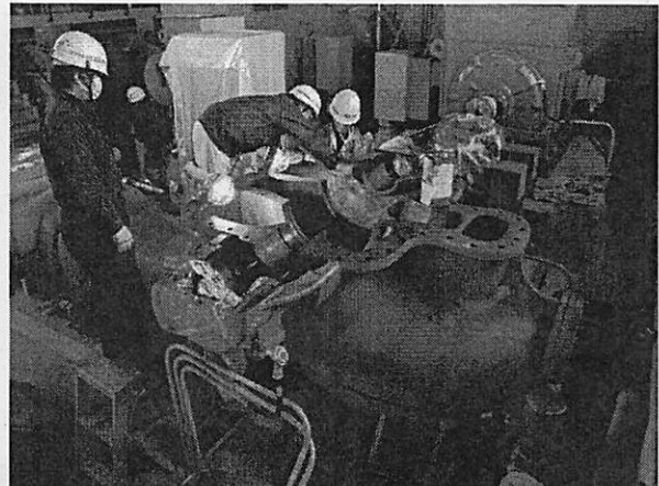
ポンプの点検
