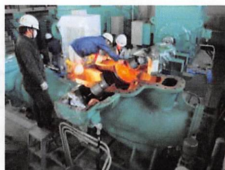
ポンプの点検で効率的送水
