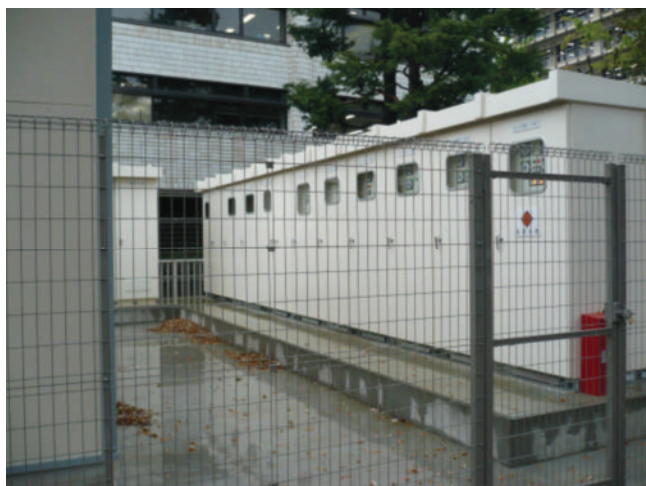
参考) 埼玉県危機管理防災センター 自家発電機等の配電盤
