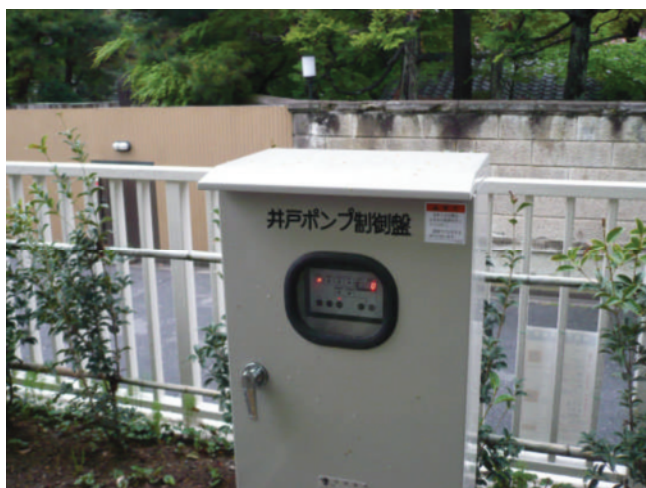
参考) 埼玉県危機管理防災センター 井戸ポンプ制御盤
