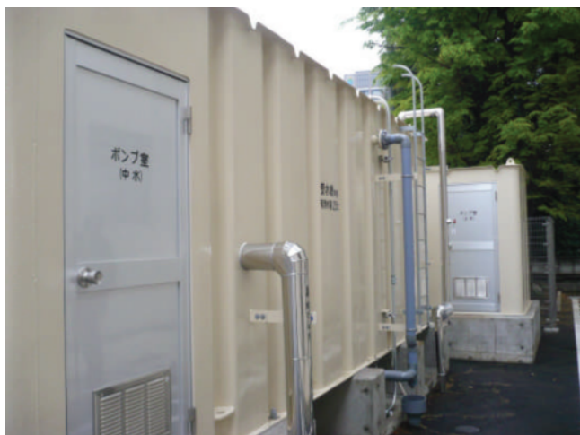
参考) 埼玉県危機管理防災センター ポンプ室
