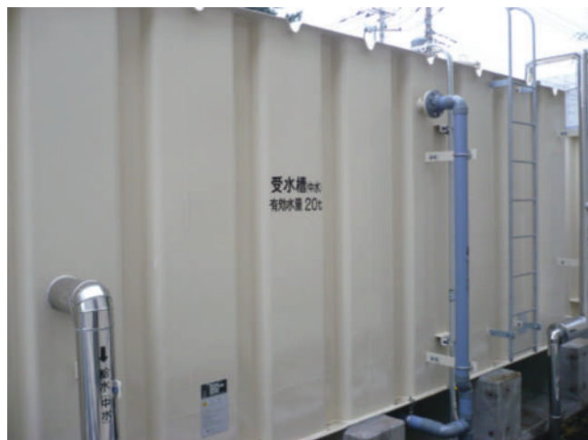
参考) 埼玉県危機管理防災センター 受水槽
