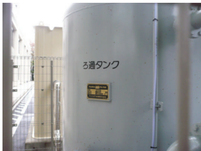
参考) 埼玉県危機管理防災センター ろ過タンク
