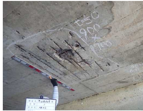
橋梁の老朽化による損傷事例
