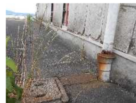
外壁パネルの破損
