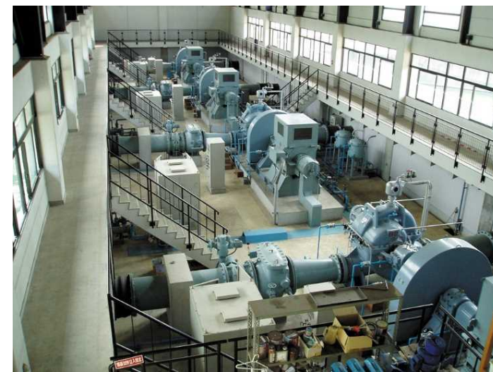
節電・省力化等の推進（揚水機場）
