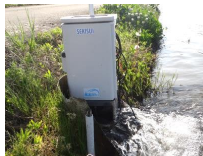
自動給水システム
