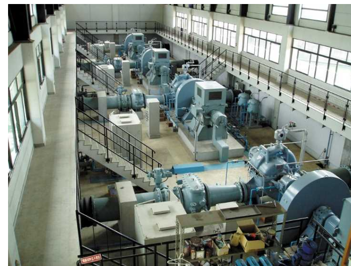
節電・省力化等の推進（揚水機場）
