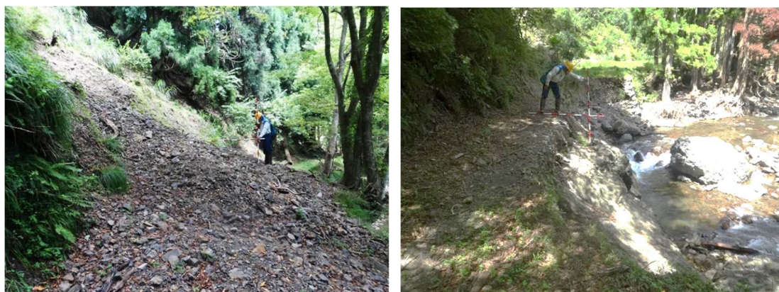
図 12： 林道の被災状況（左 土砂流入、右 路体流出）
