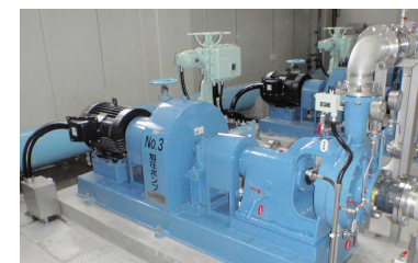
日野第一加圧ポンプ場
