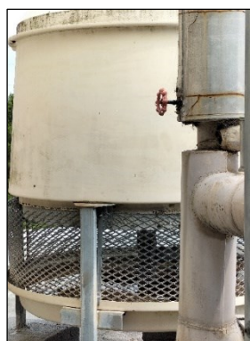
冷房装置故障
