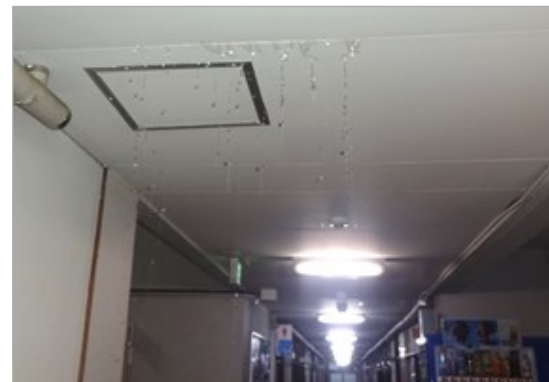
天井からの漏水 (R5)
