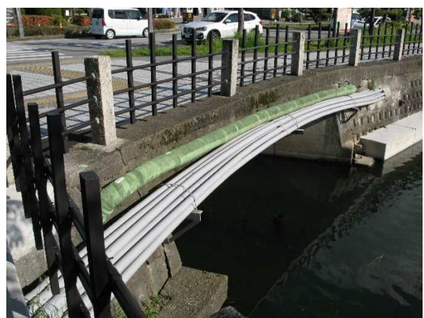
例：港湾占用許可を受けて設置されている架設管類
