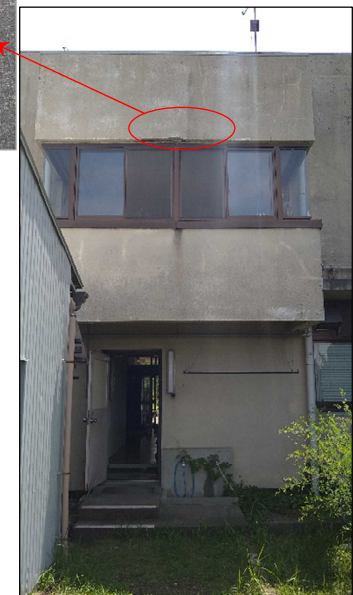
本館外壁の崩落(R4)
