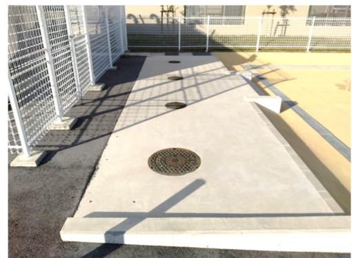
防災トイレ (マンホール)
