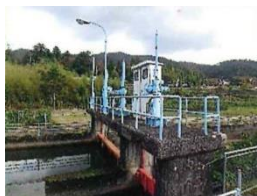
制水ゲート (機側操作盤老朽化)
