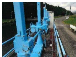
取水口ゲート (開閉装置腐食)
