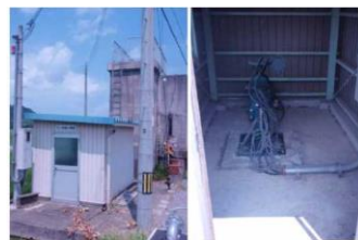
(既設地下水揚水機)
