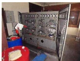
洪水吐ゲート (油圧ユニット油漏れ)
