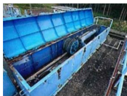
洪水吐ゲート (開閉装置腐食)
