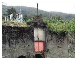
排水ゲート (全体腐食)
