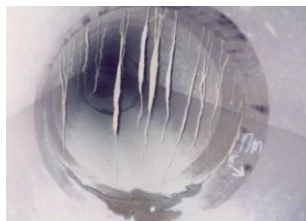
(幹線水路の破損状況)
