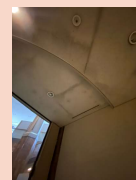
陶芸館地下天井 (雨漏り)
