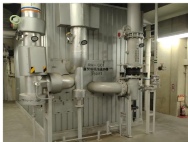
(写真6) 熱源設備
