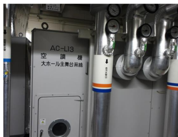
(写真7) 空調設備
