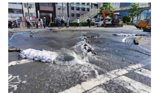
埋設管の老朽度確認へのDX活用の重要性 京都市下京区の水道管漏水事故 （出典：国土交通省資料）
