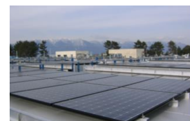
太陽光発電設備
