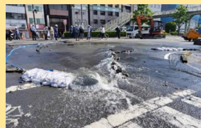
京都市下京区の水道管漏水事故（出典：国土交通省資料）
