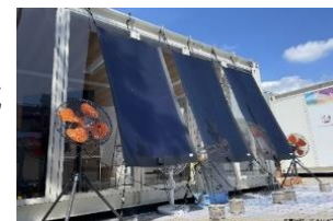
ペロブスカイト太陽電池の活用例 写真提供:積水化学工業(株)
