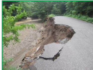
No.75 路肩欠損
