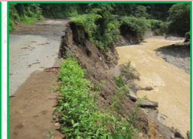
No.56 路肩欠損
