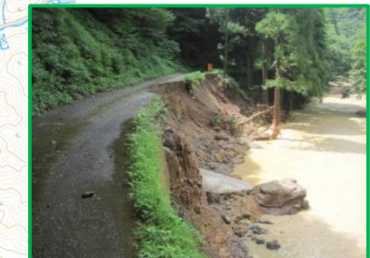
No.54 路肩欠損
